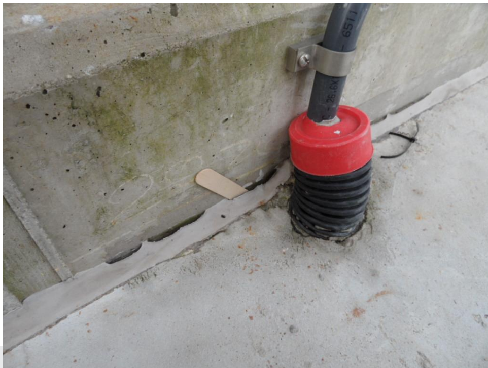
Foto: Gebrek aan afdichting.
